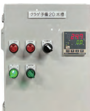
各種制御盤製作
